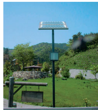
Figura 4 Un pannello di celle solari fornisce energia in una località non raggiunta dalla rete elettrica.
